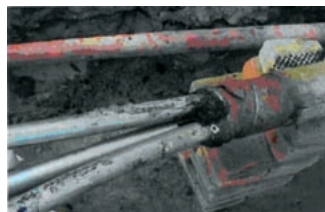
Рис.2: Коррозия внешней оболочки и локальная коррозия свинцовой оболочки
